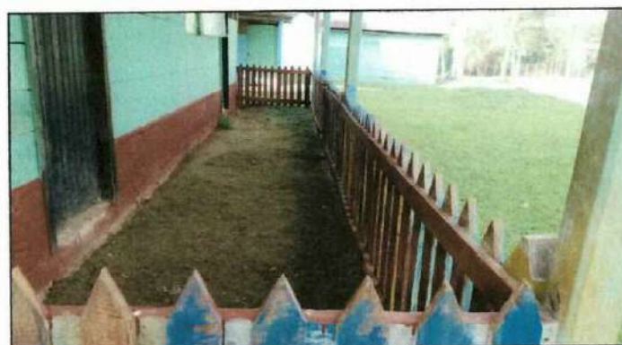
Foto 4: PISO DE PATIO DE TIERRA
