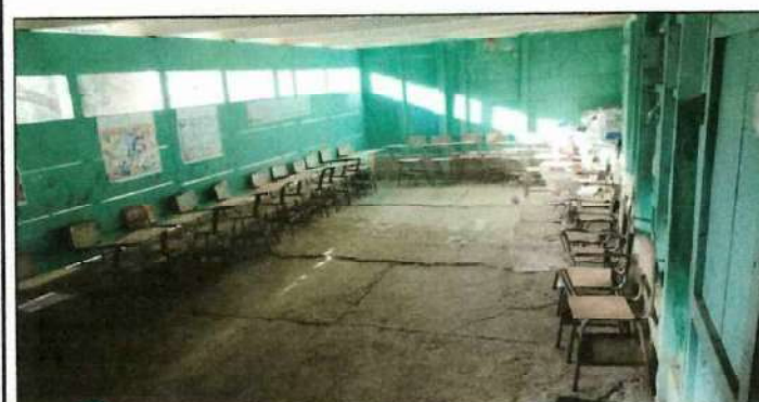
Foto 5: PISO DE AULA DETERIORADO
